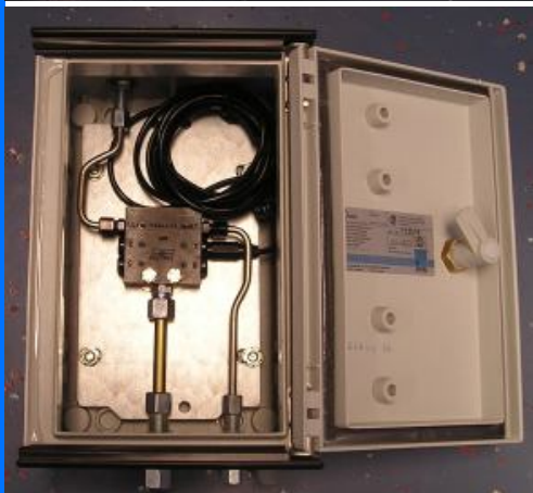
← Защитный шкаф с главным распределителем
