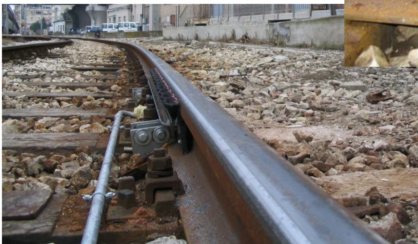
Вид смонтированной шины
