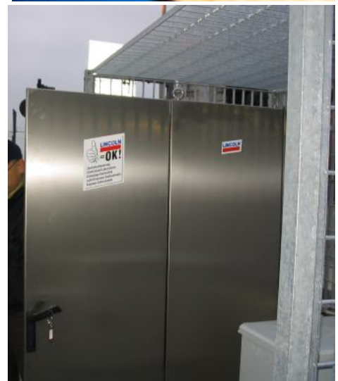
Шкаф управления общий вид
